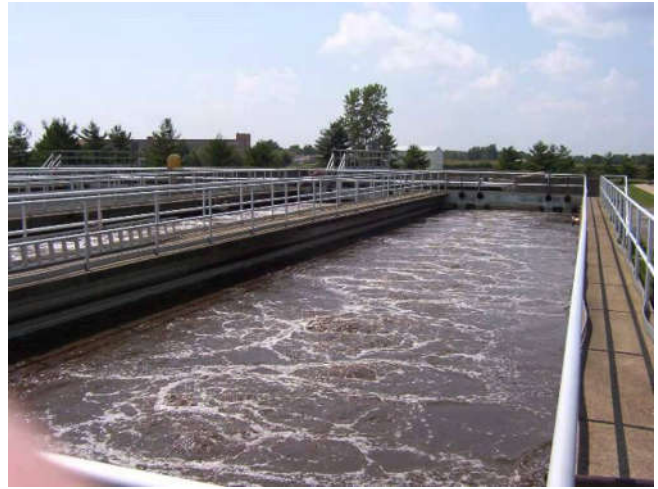
บ่อบำบัดน้ำเสีย
