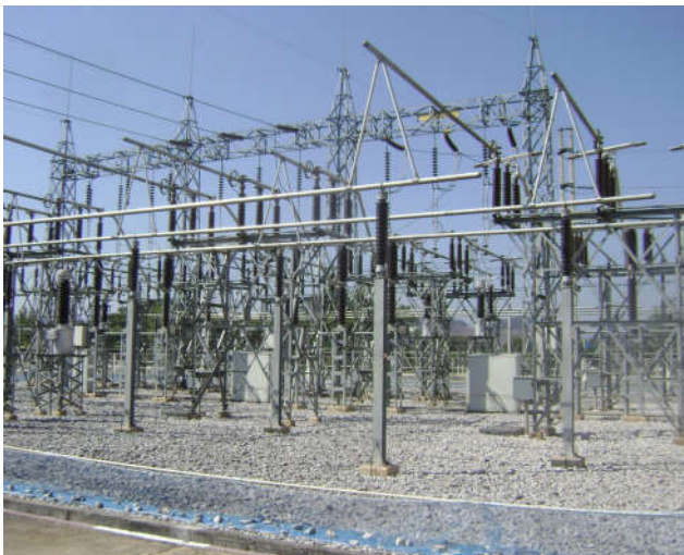
สถานไฟฟ้า
