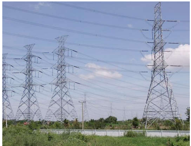
เสาไฟฟ้า
